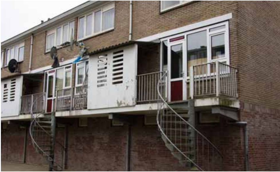
De woningen rondom de Oudegeinlaan hebben veel achterstallig onderhoud.
