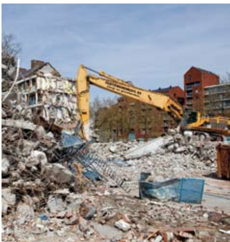
Sloop aan 't Goylaan.
